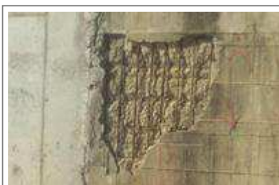
Il degrado è visibile a occhio nudo sotto il viadotto della tangenziale
